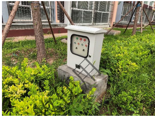
雨水调蓄池控制箱（东地块）
