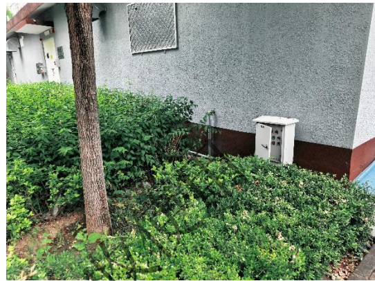
雨水调蓄池控制箱（西地块）
