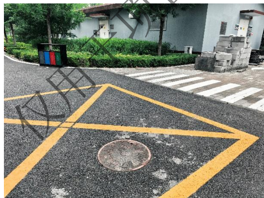
雨水调蓄池检查井（西地块）
