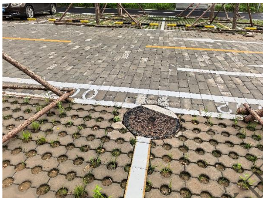
雨水调蓄池检查井（东地块）
