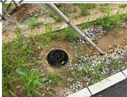
植草沟溢流井排水管
