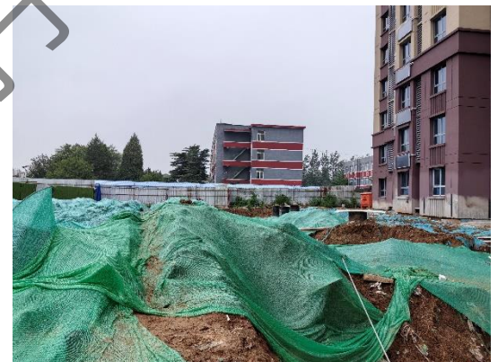
C 地块雨水调蓄池
