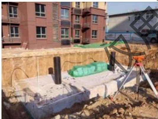
B 地块雨水调蓄池
