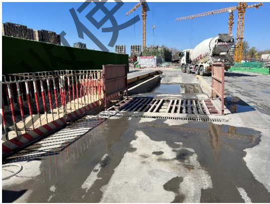
施工出入口洗车机及临时沉沙池
