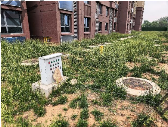
C 地块雨水调蓄池
